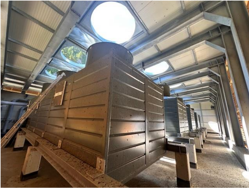
Kühlturmanlage von innen
