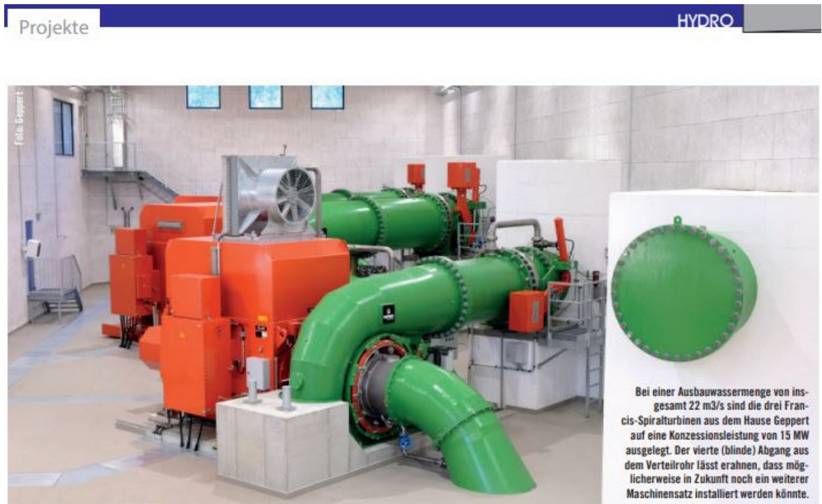
Abbildung 1 zeigt das innere des Maschinenhauses im Zuge der Eröffnungsfeier mit dem bereits vorgesehenen Anschlussrohr für die vierte Turbine (Screenshot von https://www.geppert-hydro.com/wp-content/uploads/2023/03/KW-Tumpen-Habichen_ZEK-hydro.pdf , Seite 8).
