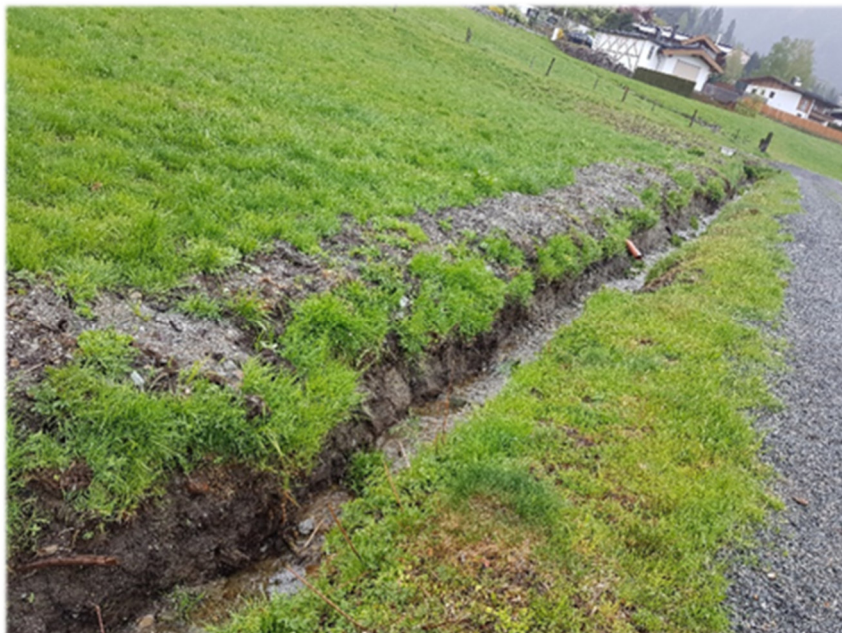
Abbildung 3: Ausgebaggerter Entwässerungsgraben (teilverrohrt) am Gst. 949/1 KG Aurach b.K. Mittig ist ein Drainagerohr ins Gerinne erkennbar.
