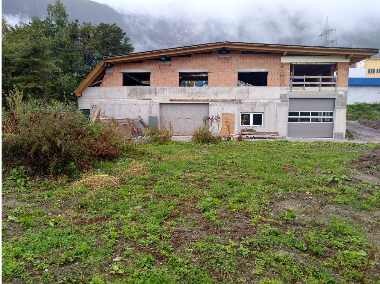
Konsenslos errichtete Anlage, Foto vom 25.09.2020
